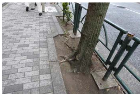
写真 浸透能が低下している街路樹の緑地
